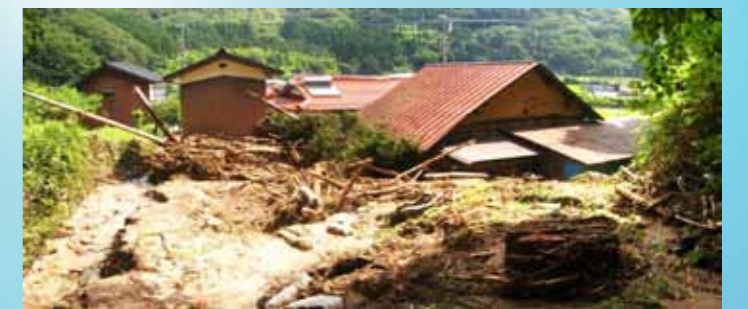
記録的集中豪雨（平成25年7月）による家屋損傷（江府町）
