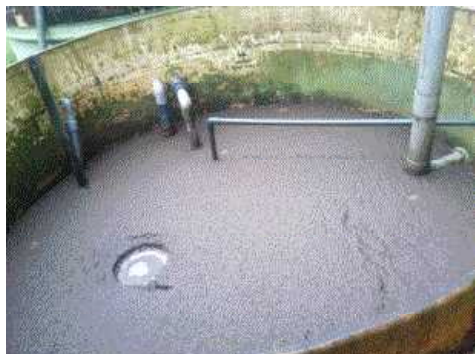
写真7 沈殿槽水面のスカム蓄積
