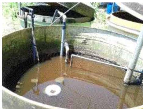
写真9 スカムスキマー設置後の沈殿槽
