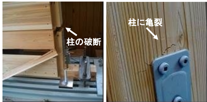
図-3 柱の破断状況
