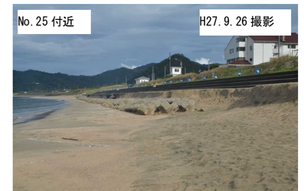
図 3.3.16 養浜後の浸食状況
