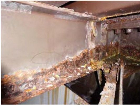
【横梁：腐食、健全性Ⅲ】
