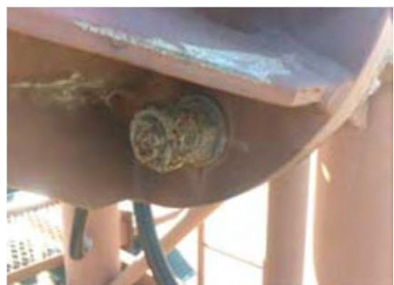
【横梁取付部：腐食、健全性Ⅱ】
