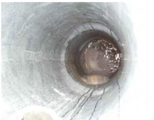
【支柱内部：滞水、健全性Ⅱ】
