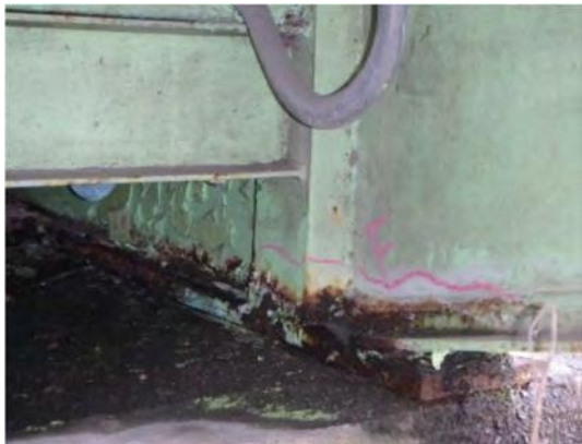
【上部工（主桁）：腐食、健全性Ⅲ】
