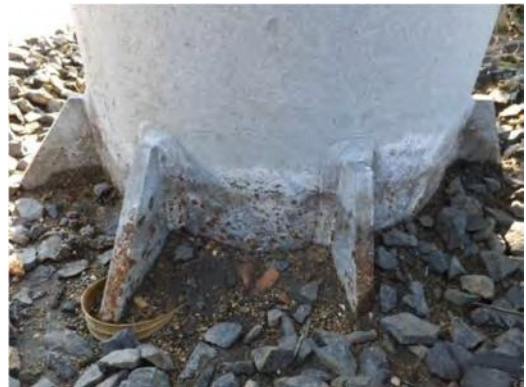
【支柱基礎：腐食、健全性Ⅲ】
