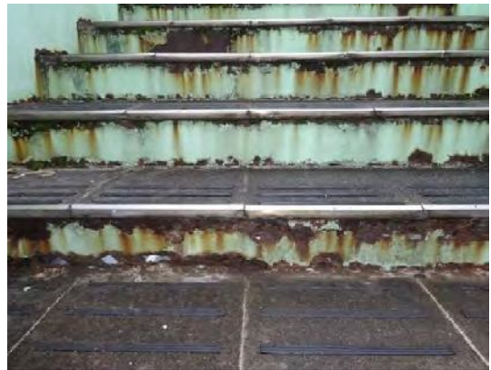
【階段部（蹴上）：腐食、健全性Ⅱ】
