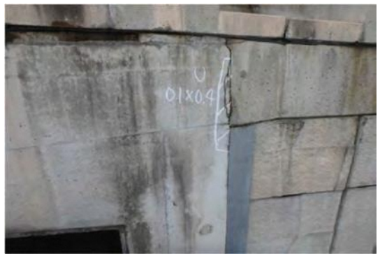
【翼壁部（ウイング）：うき、健全性Ⅲ】
