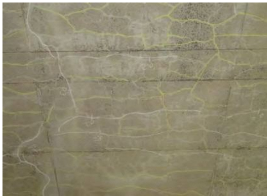
【本体工（頂版）：ひびわれ、健全性Ⅱ】
