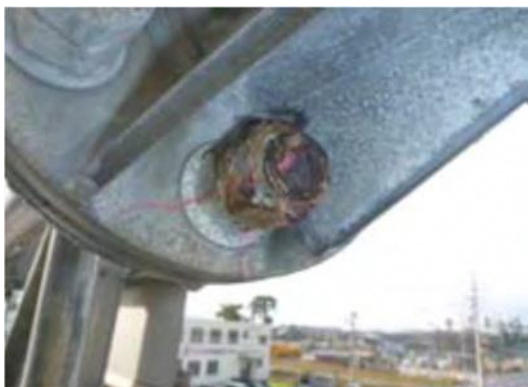
【横梁（標識板取付部）：腐食、健全性Ⅲ】
