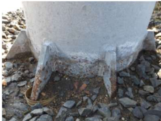
【支柱基礎：腐食、健全性Ⅲ】
