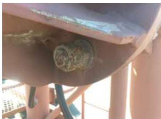
【横梁取付部：腐食、健全性Ⅱ】
