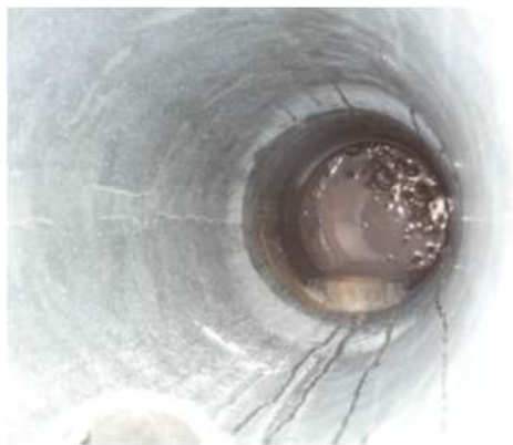
【支柱内部：滞水、健全性Ⅱ】
