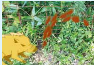
地面の沈下により生じた隙間
