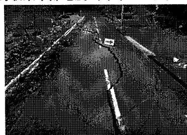
■県道三朝温泉木地山線 （三朝町三朝）路面亀裂
