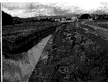
■二級河川由良川水系北条川 （倉吉市大谷茶屋） 護岸前傾・背後沈下
