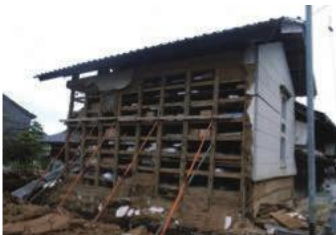
写真3 2007年に発生した能登地震後の土蔵（土が落ちると延焼の可能性が高まる）
