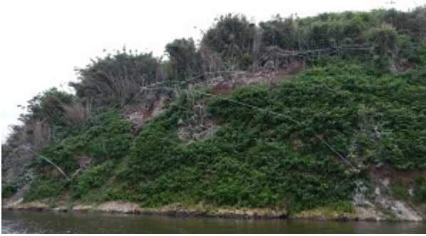
図6 ビニルひも設置後の状況 (6/28撮影)
