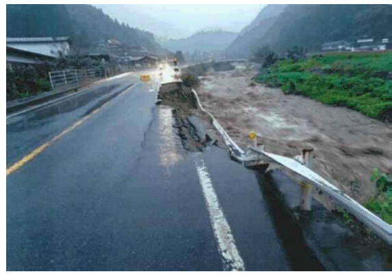
国道180号(日野町濁谷)護岸崩壊
