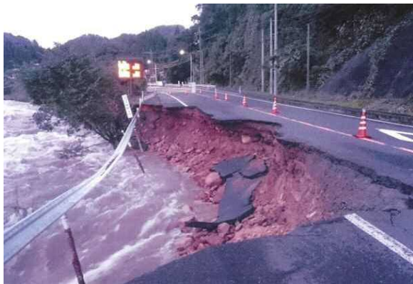
国道179号(三朝町久原)護岸崩壊
