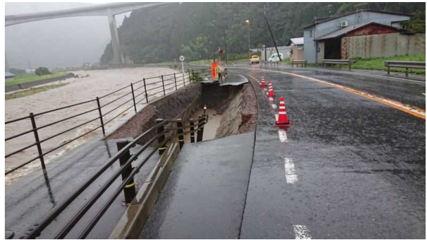
国道53号 (智頭町市瀬) 護岸崩壊
