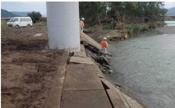
千代川 (鳥取市国安) 護岸崩壊
