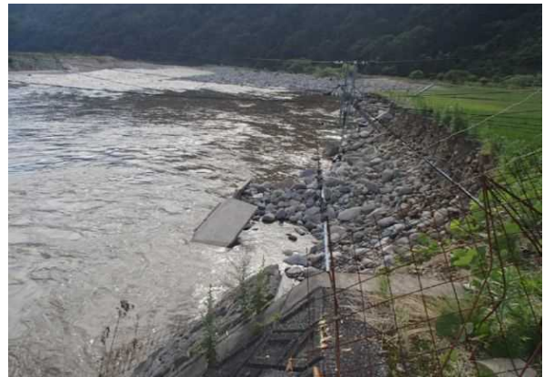
八東川(八頭町用呂)護岸崩壊
