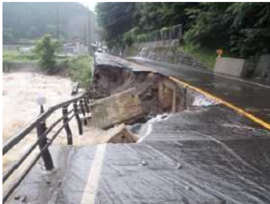
国道373号(智頭町福原)護岸崩壊
