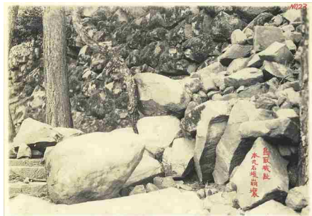
200 鳥取城址本丸石垣崩壊
