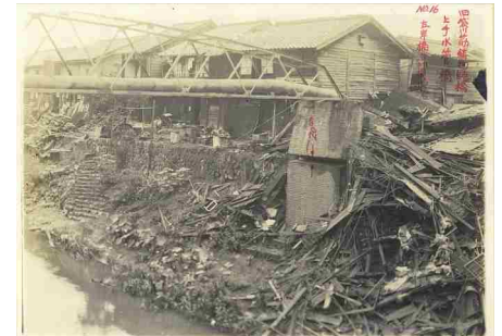
132 鋳物師橋水管橋付近の被害状況
