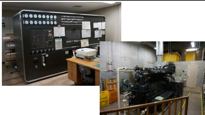
監視盤と発電機
