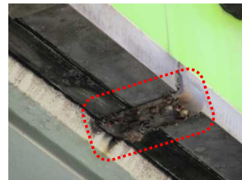
金具が劣化した状態
