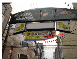
幕材を張る部材が破損した 状態
