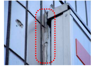
コーキングが劣化した状態
