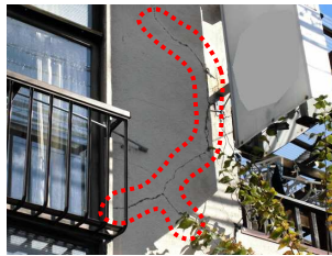
壁面にひびが生じた状態
