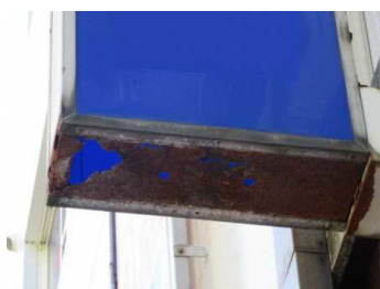
側板底面が腐食、破損した状態
