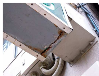
側板底面が破損した状態
