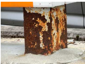
支柱根元の腐食が進行した状態
