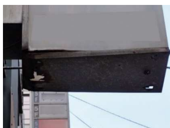
側板底面が腐食、破損、変形した状態
