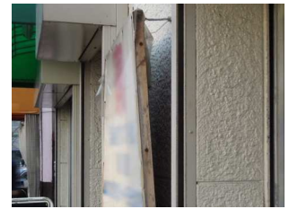
壁面との間に隙間が生じた状態
