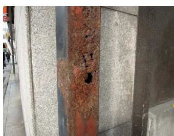
支柱の腐食が進行した状態
