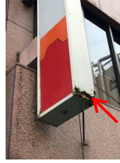
広告板底部の腐食が進行した状態
