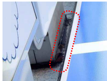
コーキングが劣化した状態
