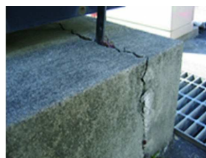
基礎にクラックが入った状態
