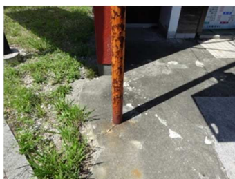
支柱の腐食が進行した状態
