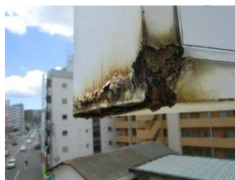
側板の腐食が進行した状態
