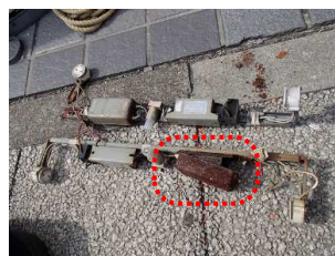
変圧器 (トランス) のさびが進行した状態
