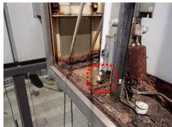
蛍光灯のホルダーが破損した状態
