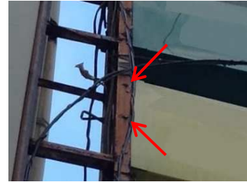
ボルトのゆるみや欠落した状態
