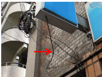
振れ止め棒が変形した状態
