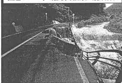
国道373号（智頭町福原）護岸崩壊
