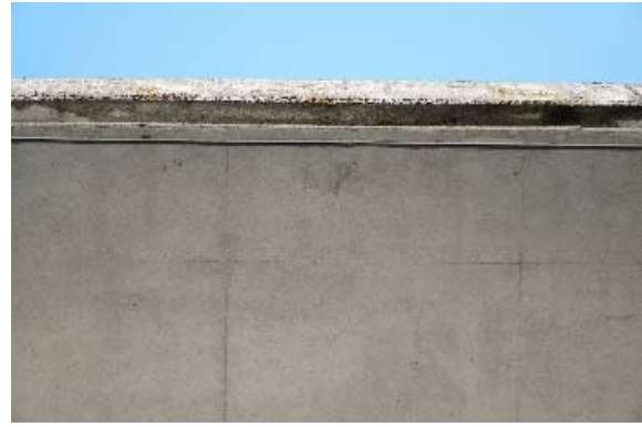
張出床版下面
