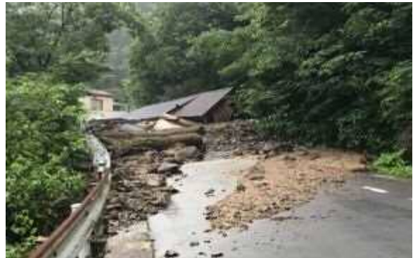
県道鳥取鹿野倉吉線（三朝町三徳）土砂流出
