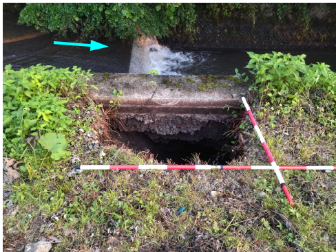
【東谷川 護岸天端の陥没】
