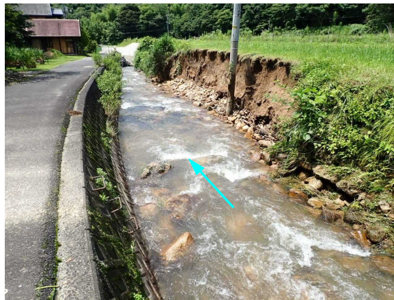
【八金川 被災状況】
