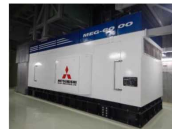
ガスタービン発電機
