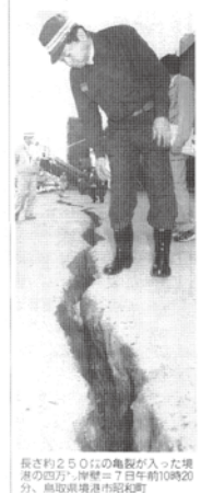
長さ約2.50mの亀裂が入った堤原の四方。押替=7日午前10時20分、鳥取県米子市和町
