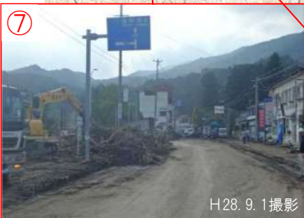
道路上に堆積した土砂、塵芥の撤去状況
