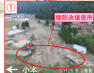
堤防決壊状況
