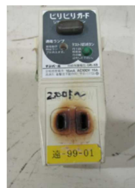
（焦げ跡のついた漏電遮断器）
