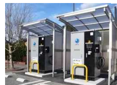
充電施設 蓄電池
