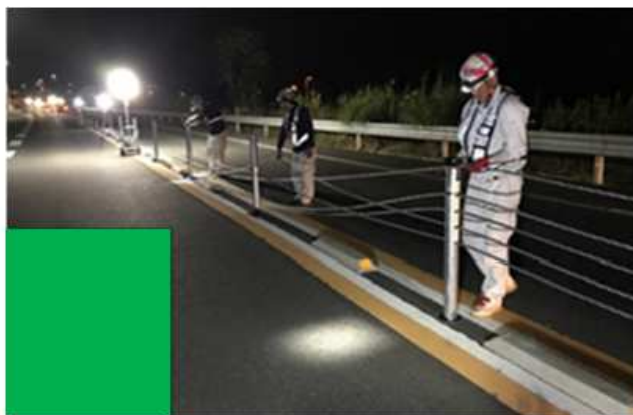
工種名：ワイヤロープ設置工 改定概要：高規格道路暫定2車線区間に設置が位置づけられたため新規制定
