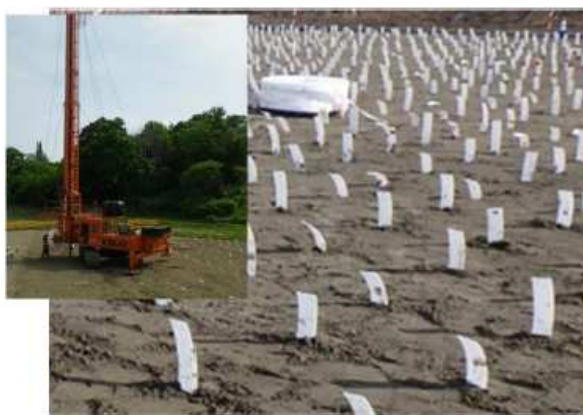
工種名：PVD工 改定概要：軟弱地盤処理工のうちPVD工法を新規制定
