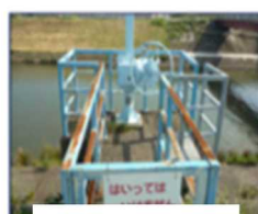
手動式の樋門
