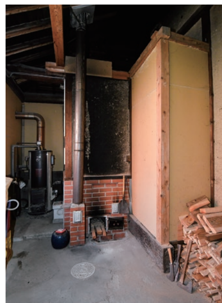
浴室の裏に設置する給湯用の薪ボイラー。お風呂、キッチンと、家中の温水をこれで賄っている。
