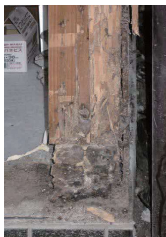
写真 4-2 柱下部の劣化
