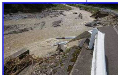
取水箇所の崩落
