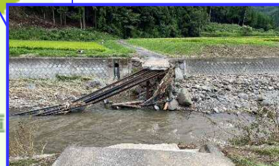
農道橋の流出
