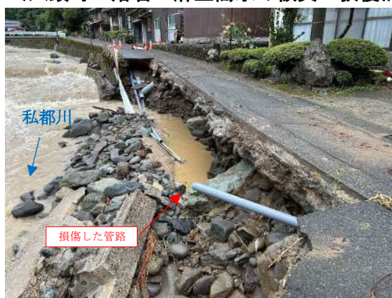
＜管路損傷状況＞
