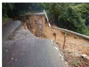
【円谷広瀬2号線（倉吉市）】 路体崩壊
