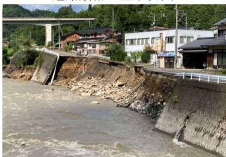
国道482号（鳥取市用瀬町別府） 道路崩落・土砂流出
