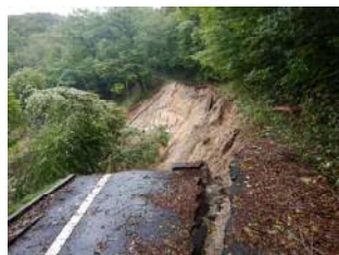
【北栗祖線（三朝町）】 路体崩壊
