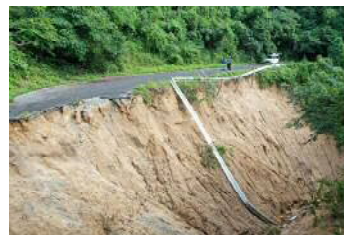
【実光福吉線（三朝町）】 路体崩壊
