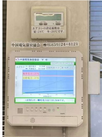
電気の使用状況を可視化し、エアコンの設定温度も管理している
