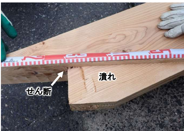
写真6 登梁尻仕口の潰れ等(箇所:図2(b))
