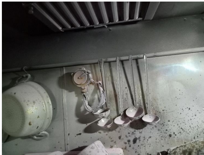
☆上のダクト内の鎮火確認に時間を要したもの
