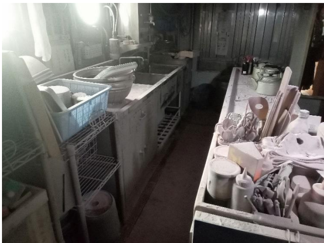
☆厨房内は消火剤で満たされており、使用不可だが、 両隣の食堂はドアで仕切られており、使用可
