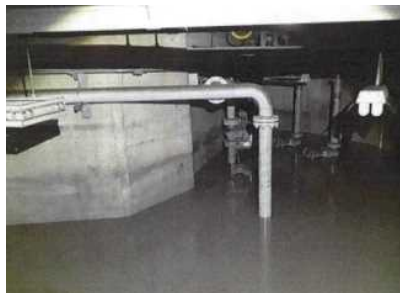
<地下5階の浸水：R5.8.17 16時>
