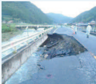
国道 180 号 (日野町濁谷) の被災状況
