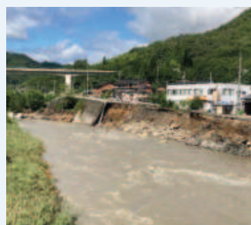
国道 482 号 (鳥取市用瀬町別府) の被災状況
