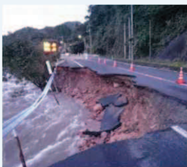
国道 179 号 (三朝町久原) の被災状況
