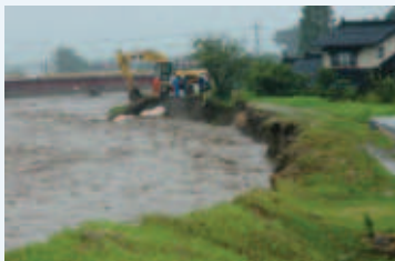
米子市河岡(佐陀川)の被災状況
