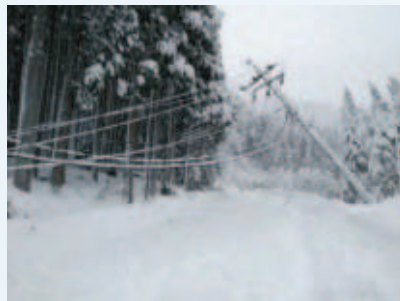
電柱倒壊の状況 (若桜町来見野)
