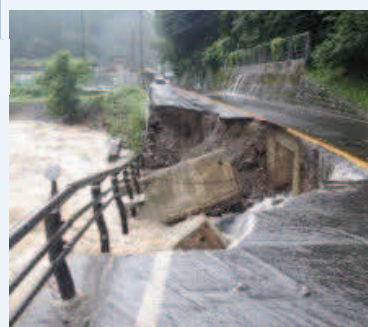
国道 373 号 (智頭町福原) の被災状況
