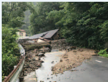
県道鳥取鹿野倉吉線 (三朝町吉原) の被災状況
