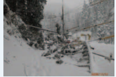
電柱倒壊の状況 (八頭町姫路)
