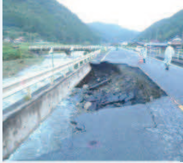
国道 180 号 (日野町濁谷) の被災状況
