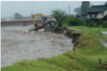
米子市河岡(佐陀川)の被災状況
