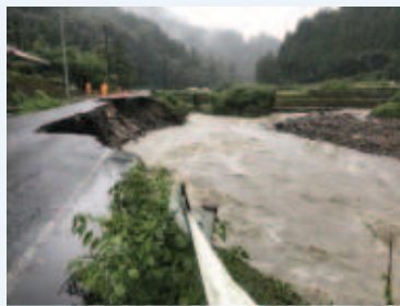
国道 482 号 (鳥取市佐治町尾際) の被災状況
