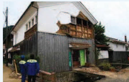
白壁土蔵群の建物被害
