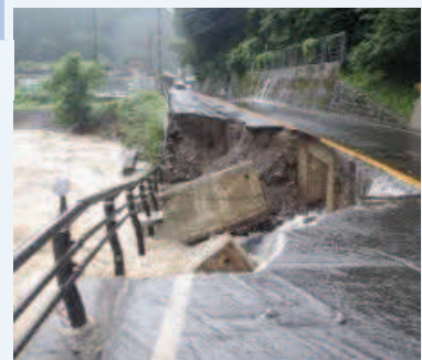
国道 373 号 (智頭町福原) の被災状況
