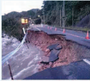
国道 179 号 (三朝町久原) の被災状況
