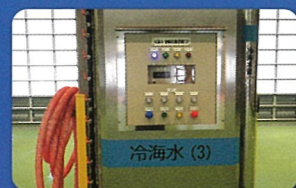
滅菌冷海水 (水温3℃) 活松葉がにや活魚取扱用の冷海水 エアポンプ 移動式活魚水槽用のエアポンプ
