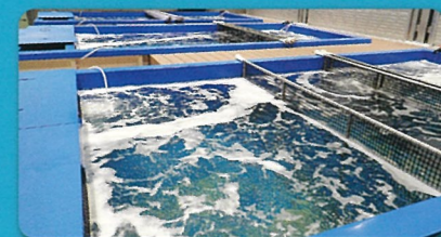
活魚水槽 (15m 2 型6基、自動ろ過、水温2~28℃) ブリ類やタイ類などの活魚を取り扱う
