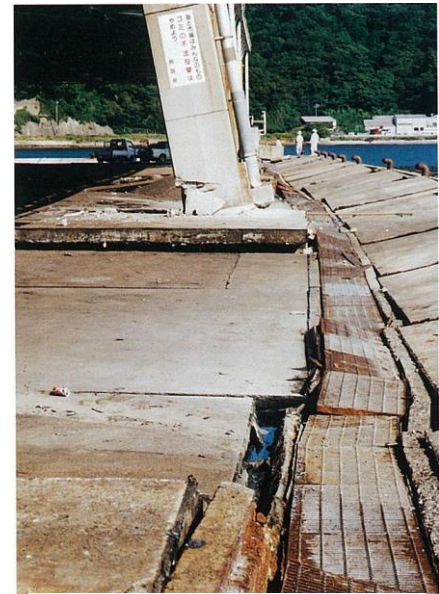
鳥取県西部地震で損壊した境漁港
