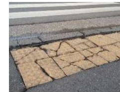
<ブロック損傷>
