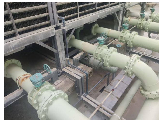
▲注薬配管長約50m
