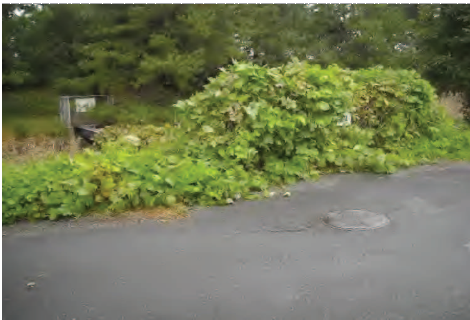
公共樹付近下水添架管
