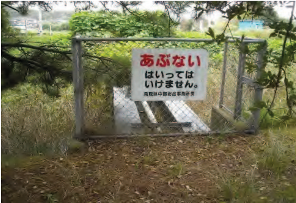
公共樹付近下水添架管
