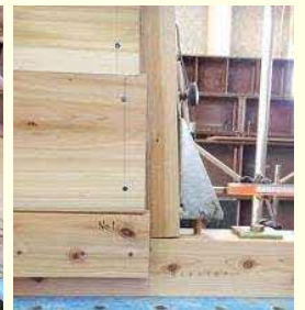
釘抜けが無く、壁板も 割れない
