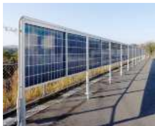
▲安来ガスセンターに設置している垂直型太陽光パネル「ソラミンゴ」
