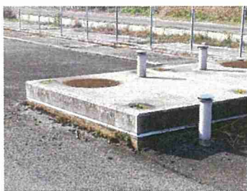
補水槽周り舗装沈下(彦名)
