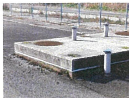
補水槽周り舗装沈下(彦名)
