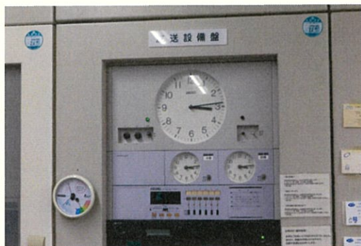
時計送設備本体
