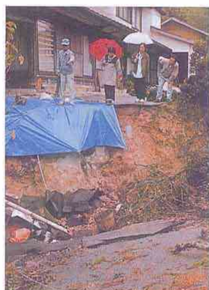
地震により発生した地すべりの側方亀裂
