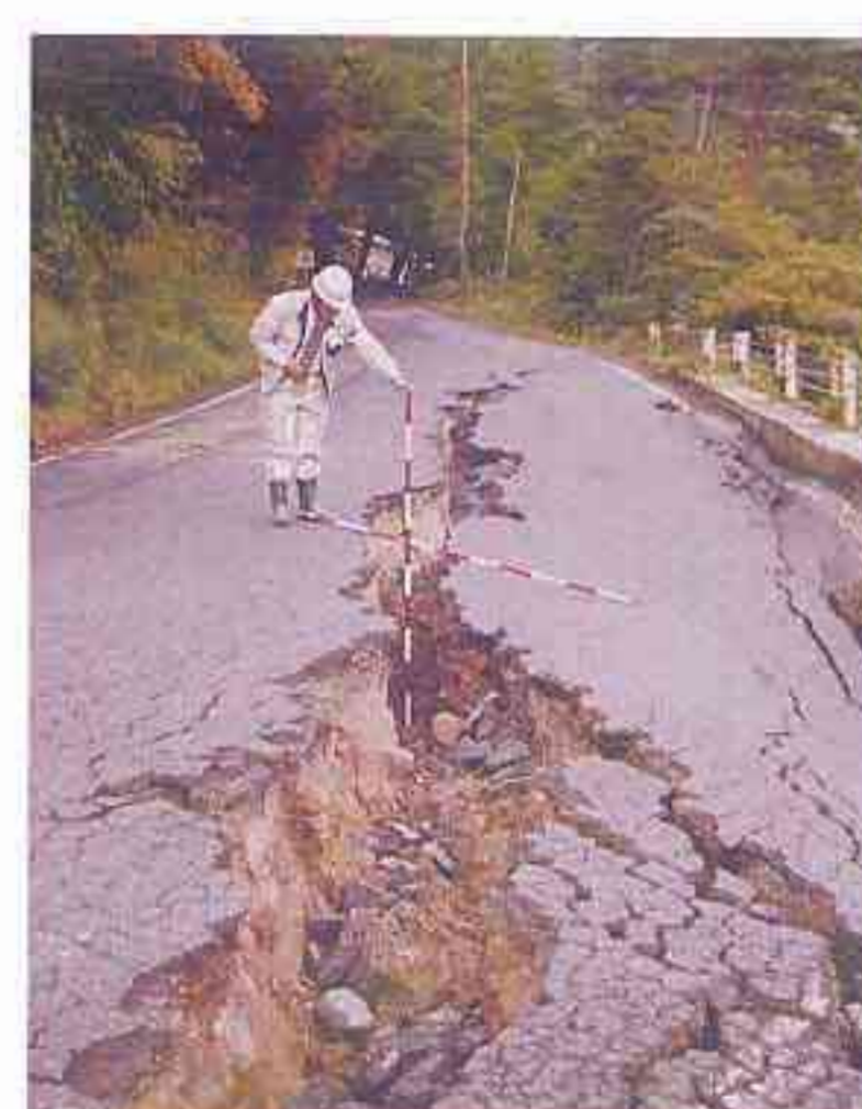
片切片盛部に多く発生した路面上の亀裂群
