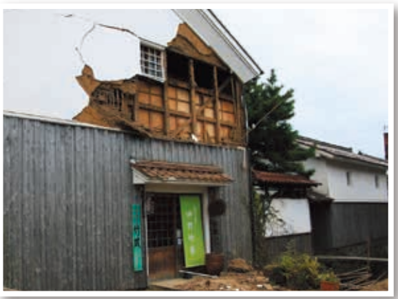
被害を受けた白壁土蔵群
