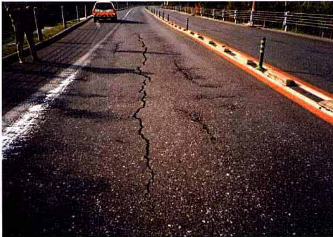
米子① KP49.25 路面クラック
