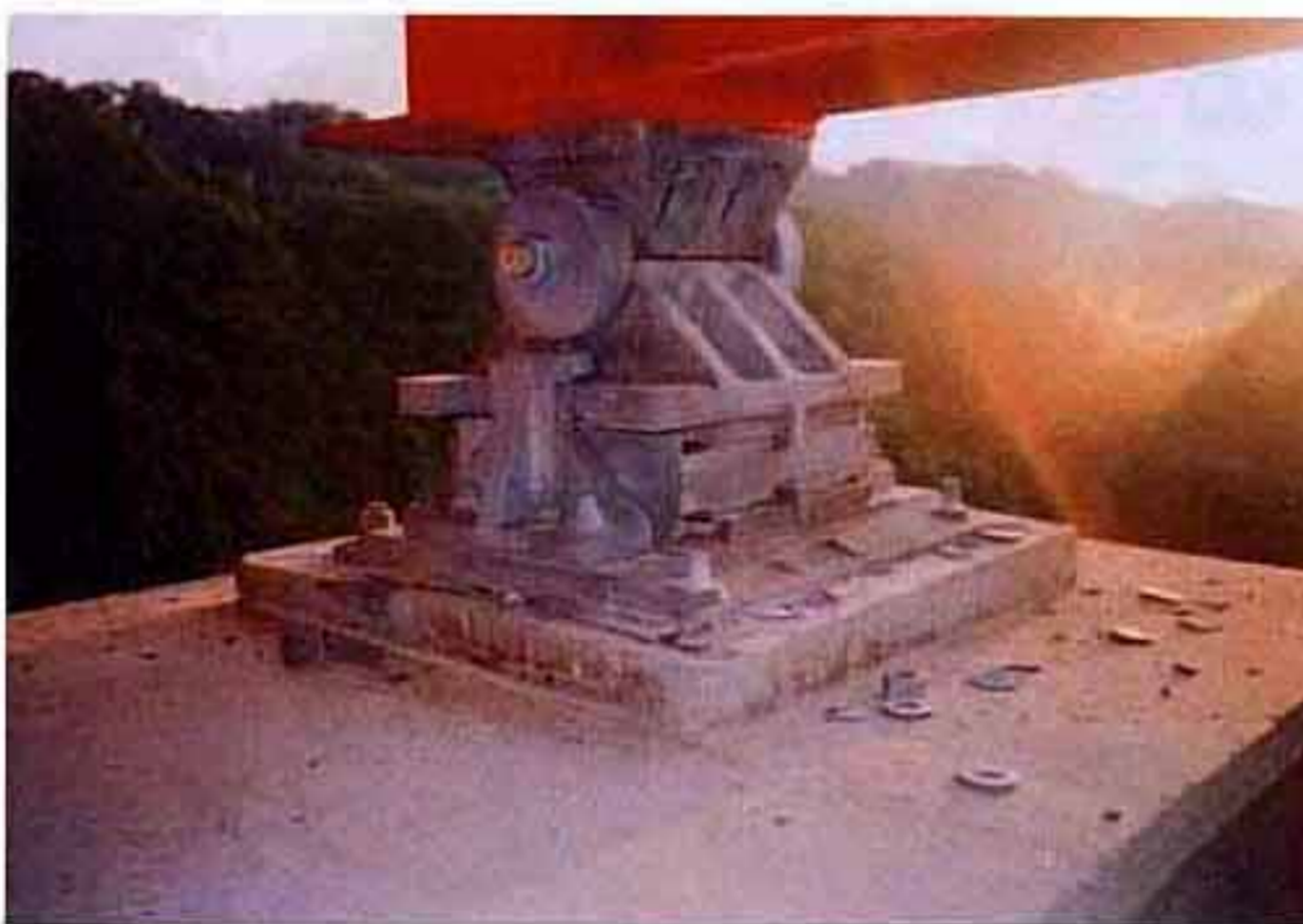
米子⑪ 大江川橋 P3G4 アンカーボルトのナット抜け落ち
