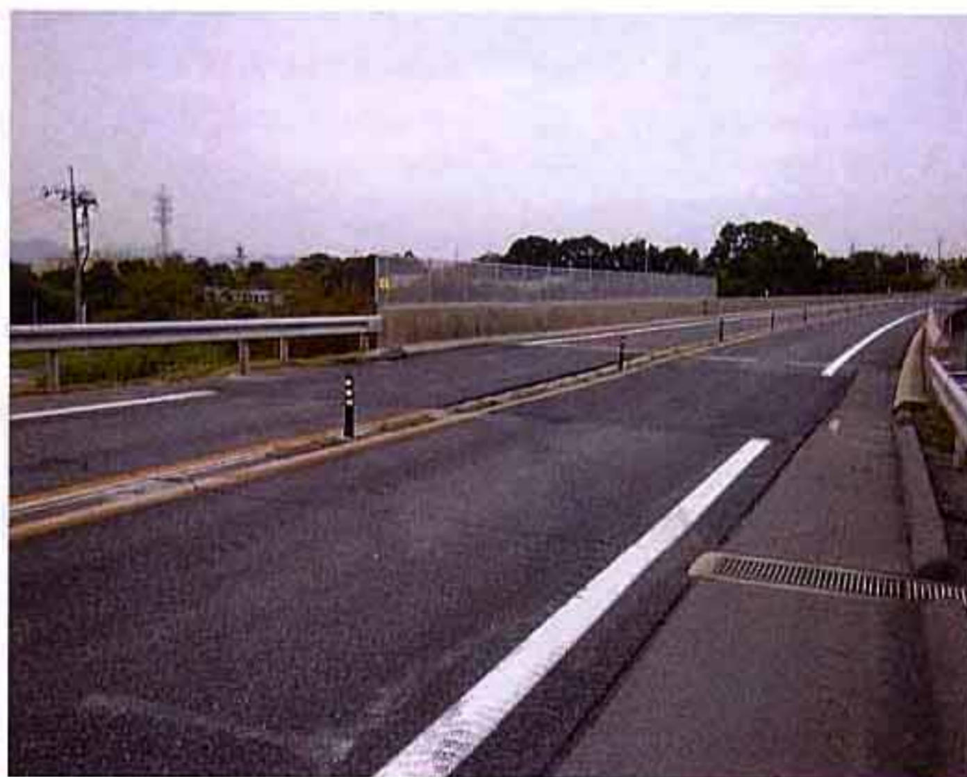
米子⑥ 別所川橋 ジョイント部段差
