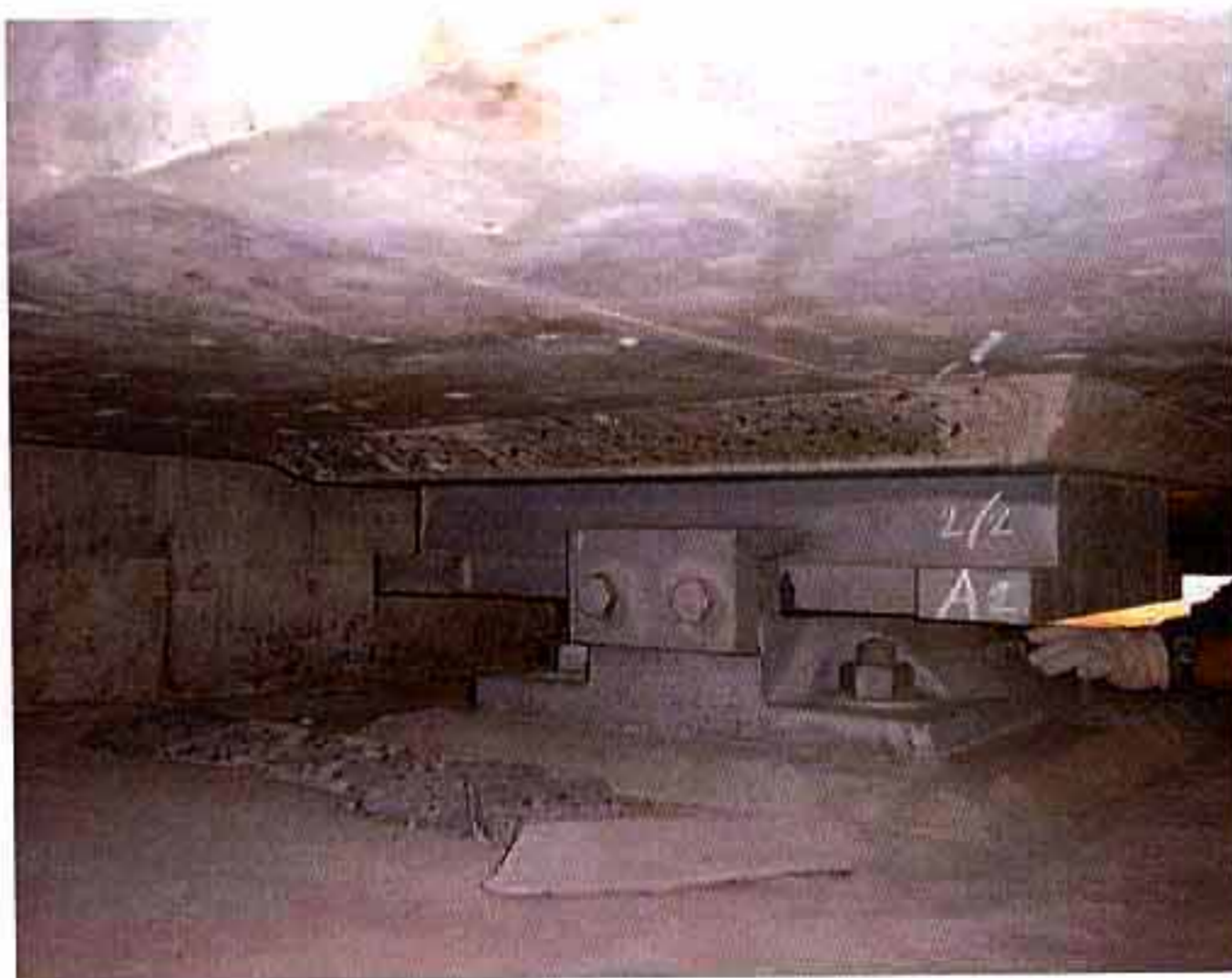
米子⑮ 白水橋 A2 レアーコンクリートの剥離 サイドブロックの変形
