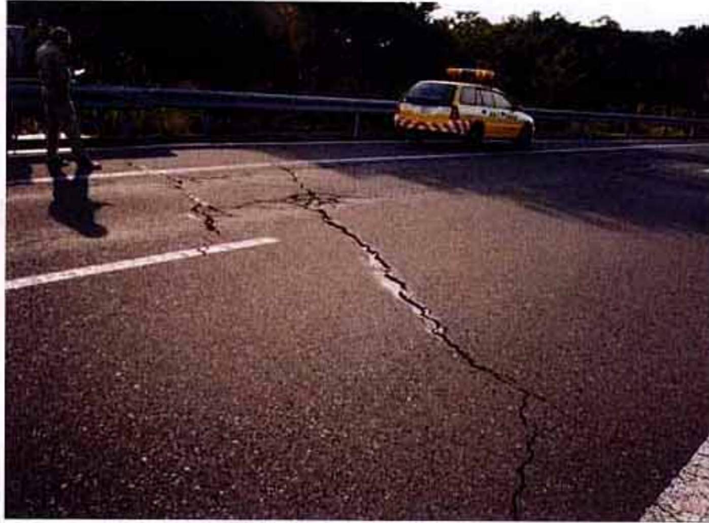
米子④ KP58.16(下) 路面クラック
