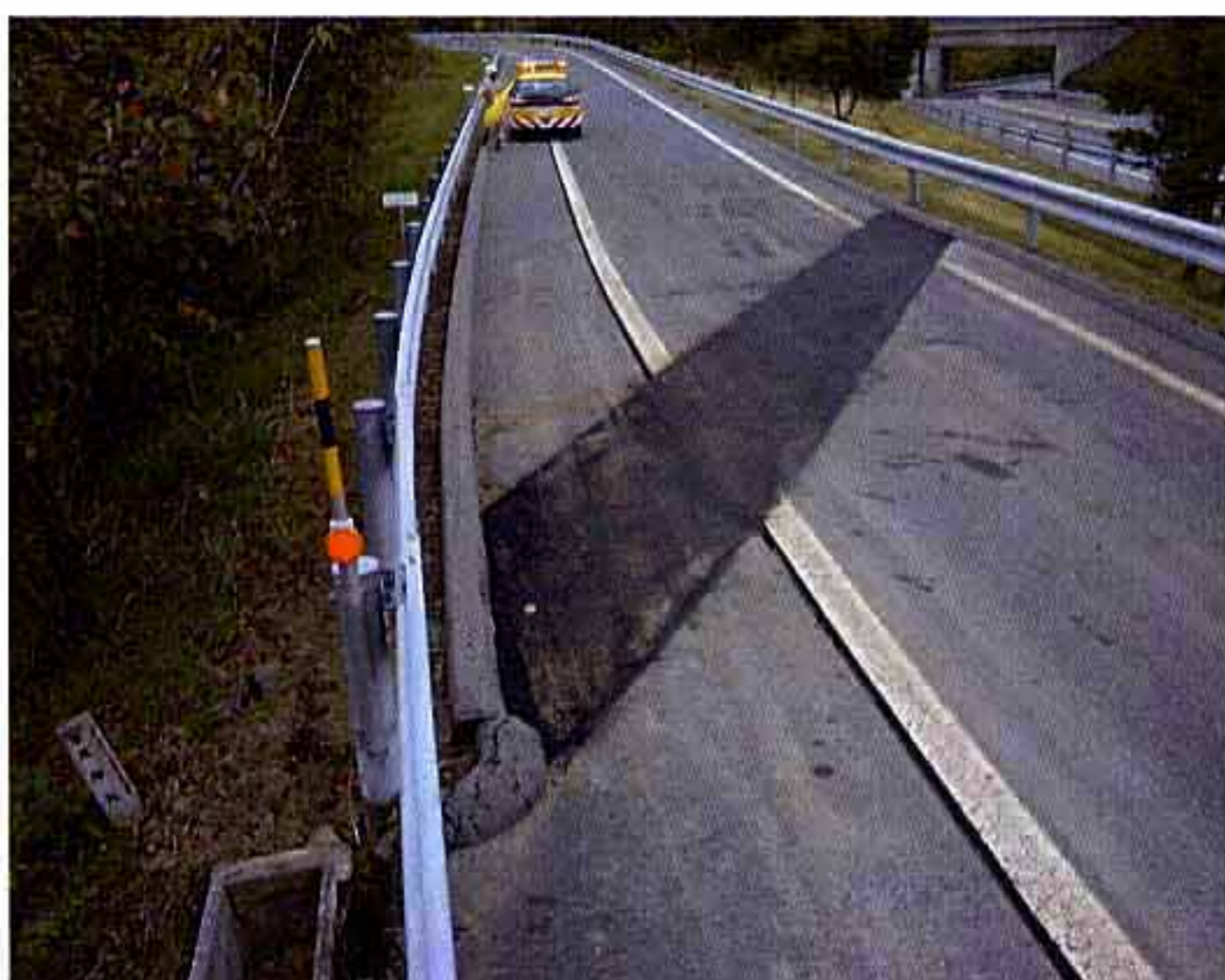
米子⑦ 江府IC Cランプ クラック段差
