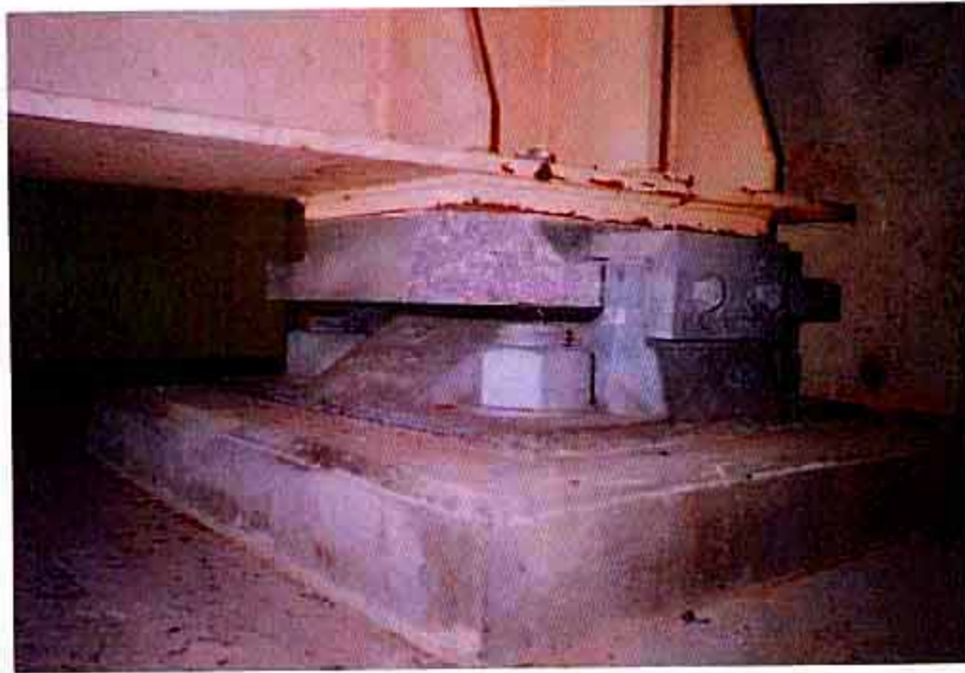
米子⑭ 清山橋 上沓の破断
