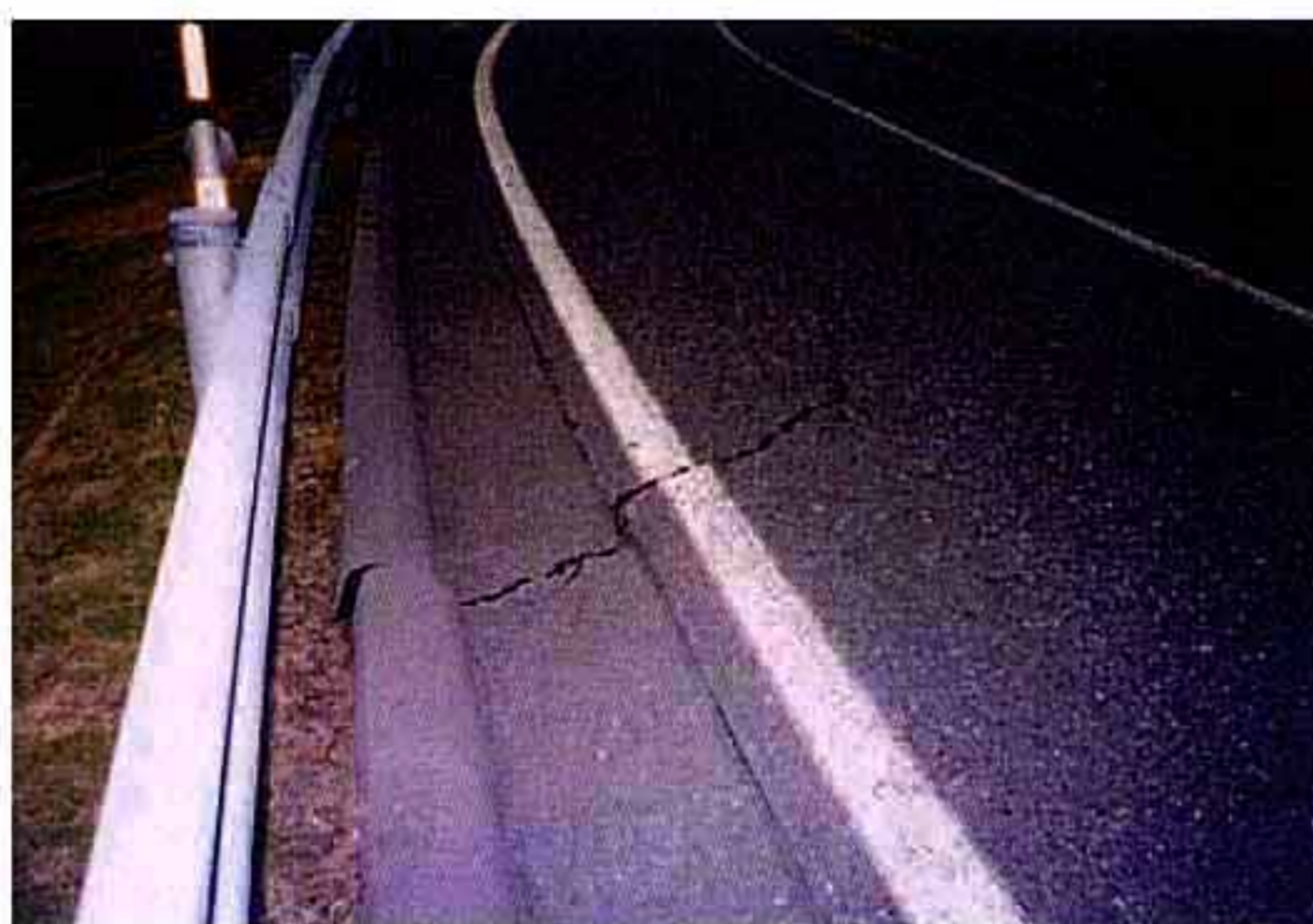
米子⑨ 江府IC Dランプ クラック段差
