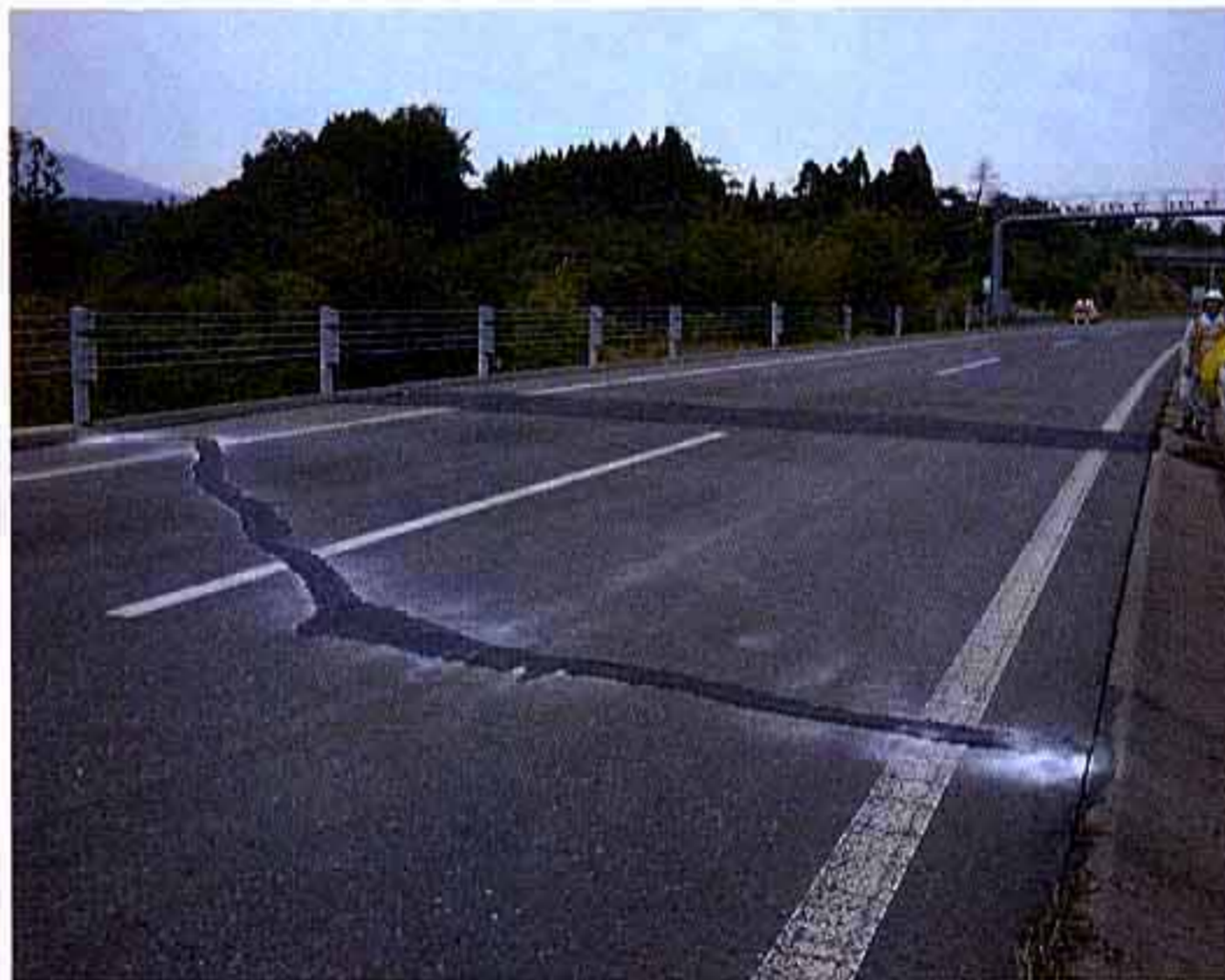
米子② KP58.1 路面クラック・段差
