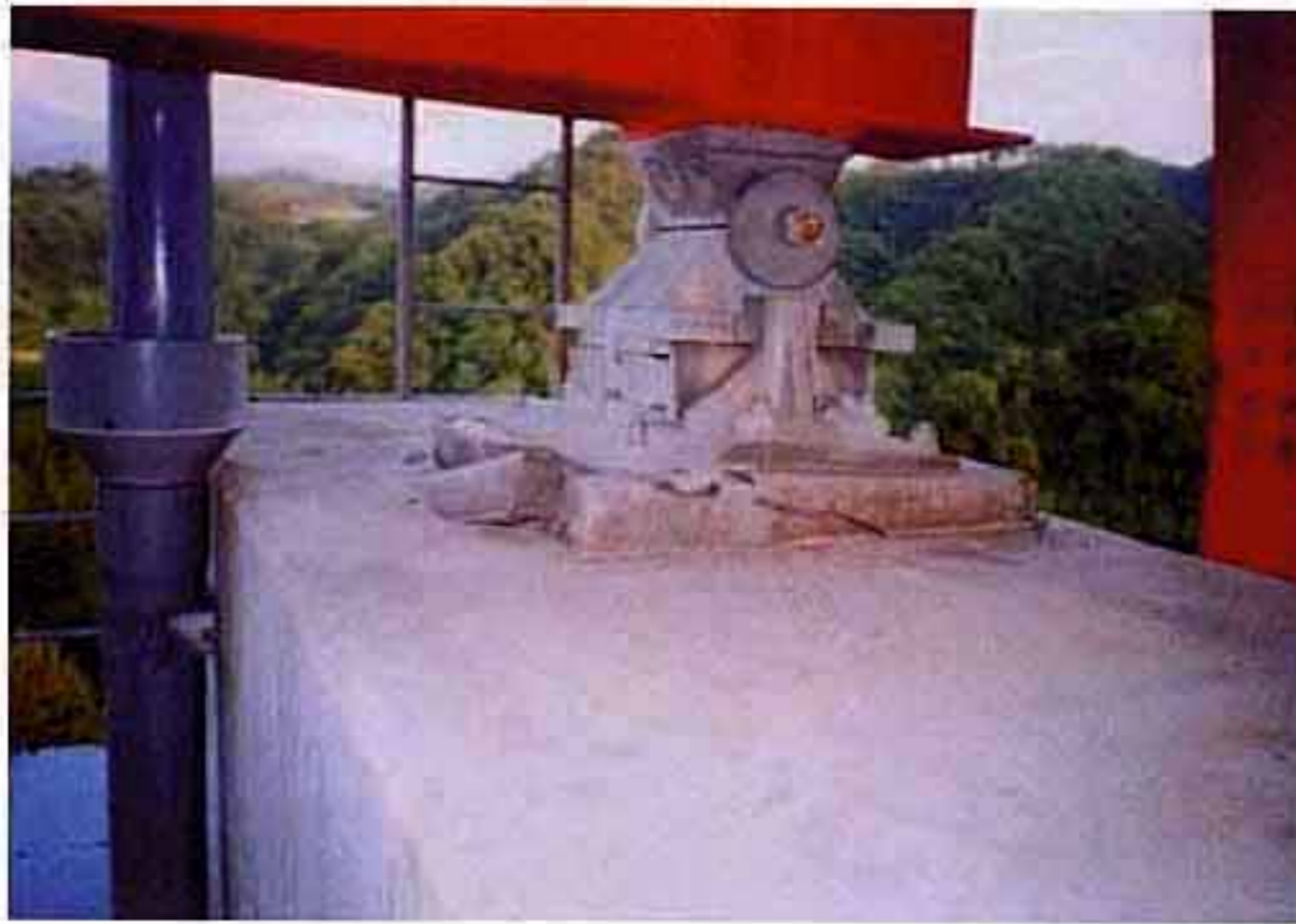
米子⑩ 大江川橋 P3G5桁 沓座コンクリートの破損
