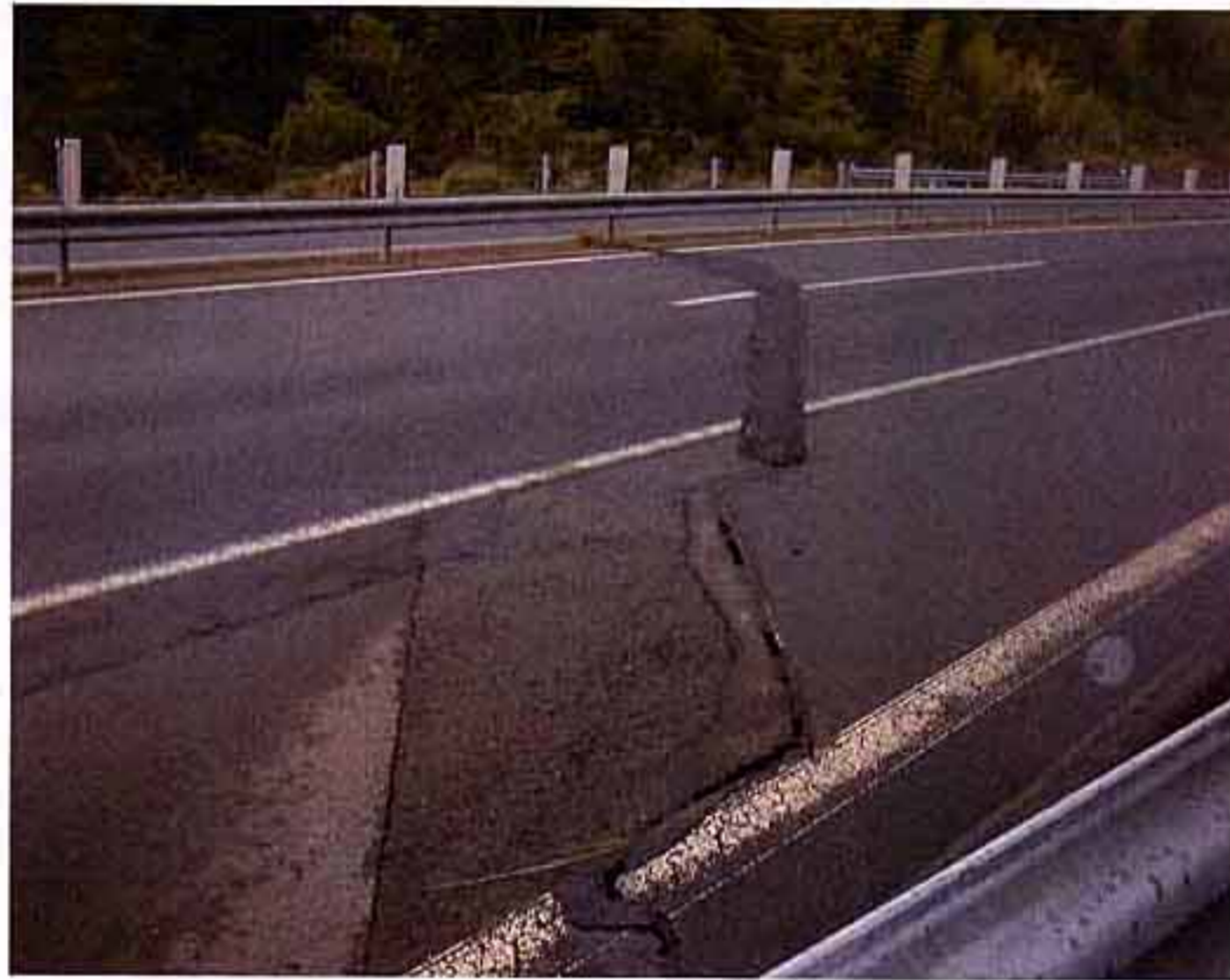
米子⑤ 路面クラック
