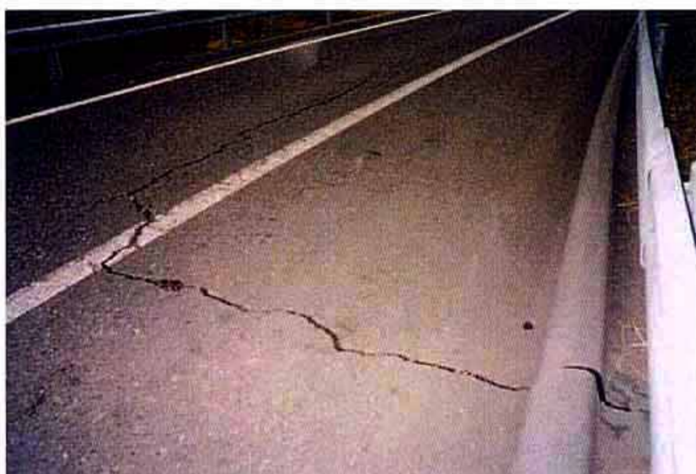
米子⑧ 江府IC Dランプ クラック段差
