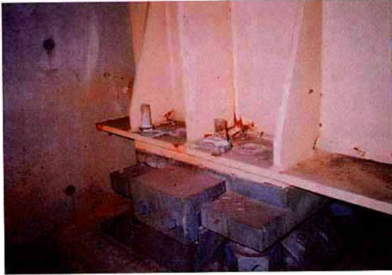
米子⑬ 清山橋 A2G4 アップリフトによるセットボルト の破断
