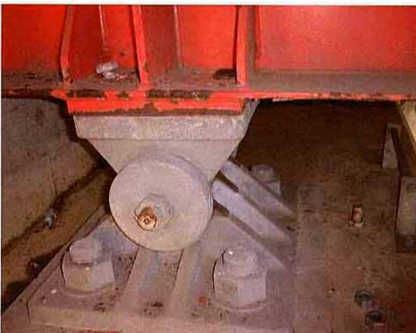
米子⑫ 大江川橋 A1 アップリフトによるセットボルト の破断
