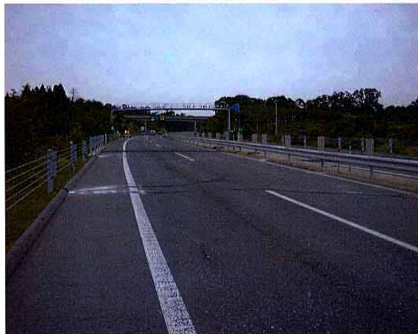
米子③ KP58.1 路面クラック・段差
